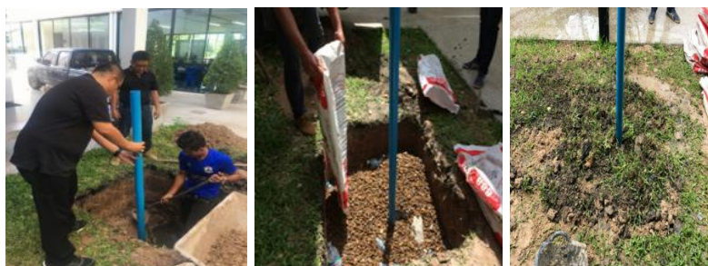
ภาพที่ 5 บ่อระบบปิด
